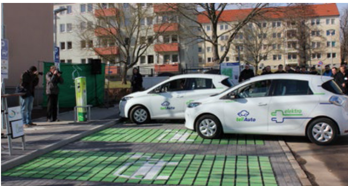
Die zwei Ladesäulen beziehen den Solarstrom vom Dach. (Foto: Chemnitzer Siedlungsgemeinschaft eG)
