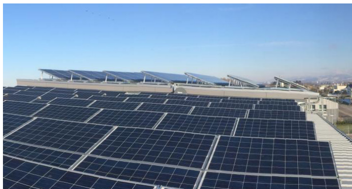
Die Solaranlagen müssen mit eigener Nummer ins Marktstammdatenregister. (Foto: IBC Solar)
